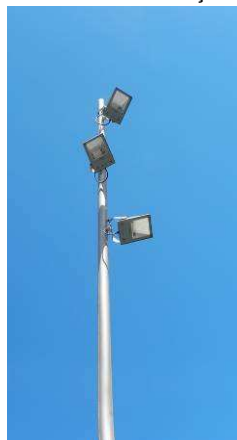
Il·luminació de la calçada
